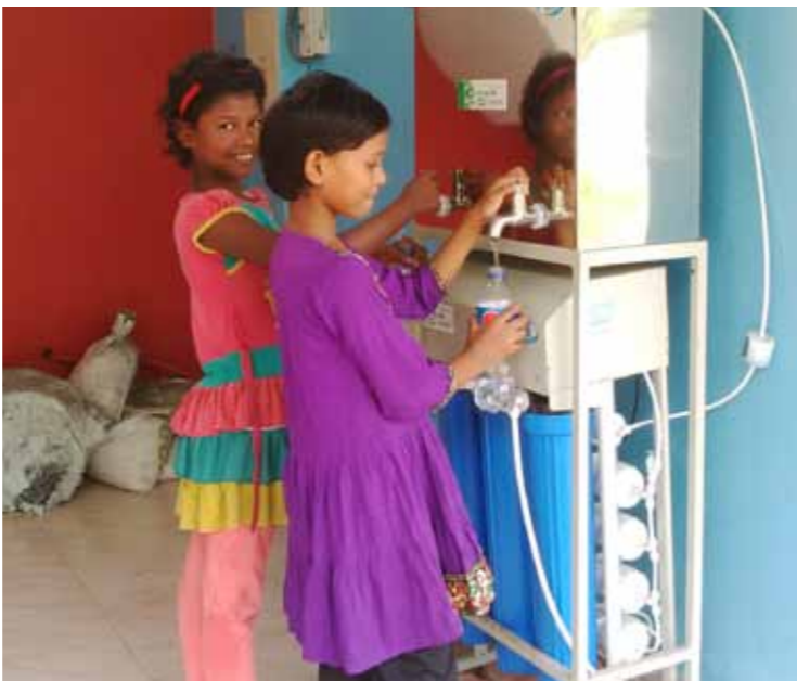
Vattenreningsanläggning installerad okt 2015.
